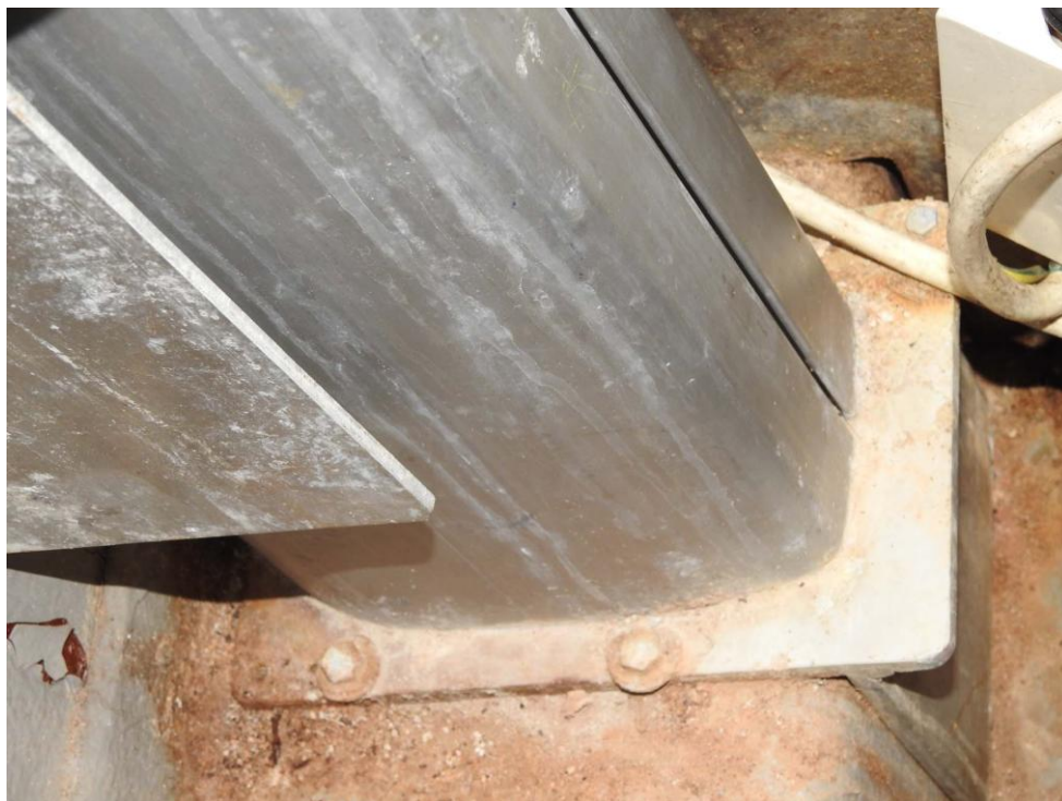
Mast Fuß unter Deck, starke Korrosion weist auf Feuchtigkeit hin
