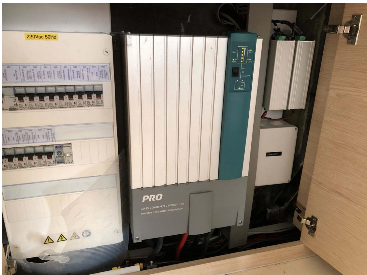
Foto (Frank Reinecke): Die 230 Volt Anlage auf einem Katamaran inklusive Ladegerät und Sinusinverter in einem Kombigerät von Mastervolt
