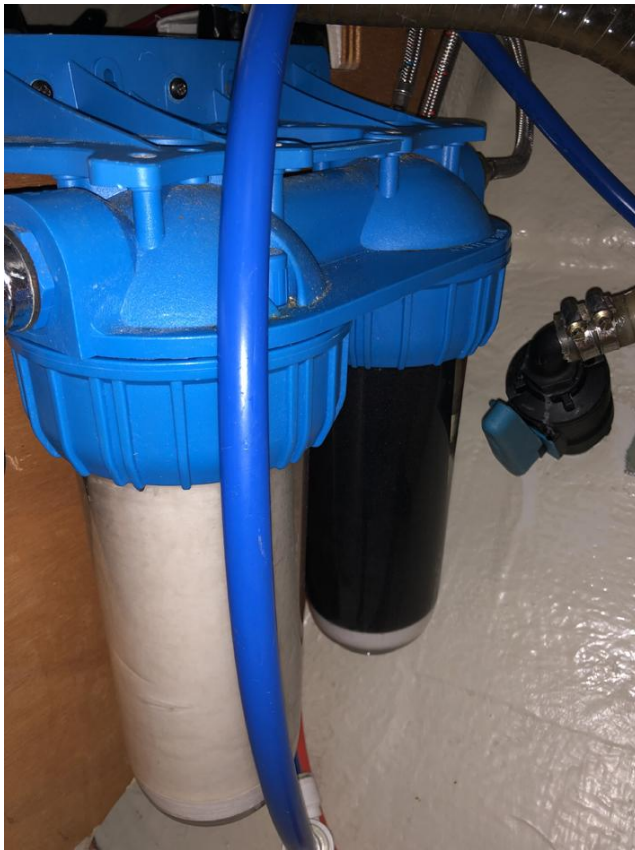
Die Filteranlage besteht aus einem Vorfilter für grobe Schwebstoffe und einem Aktivkohlefilter zur Entfernung feiner Partikel und Verunreinigungen.
